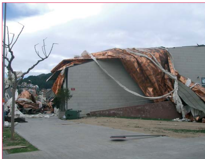
■ El vent va aixecar la coberta del Pavelló Poliesportiu, si bé l'estructura es va mantenir.
